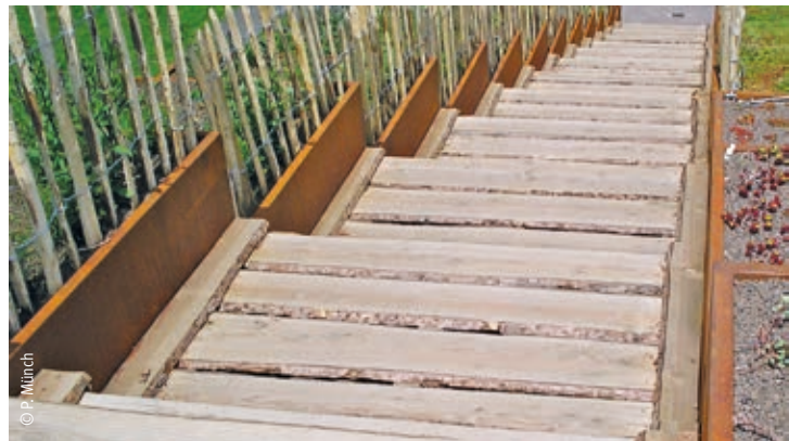
Holztreppe, der Witterung ausgesetzt: Gebrauchsklasse 3.2
