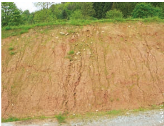
Erosionserscheinungen an einer Straßenböschung
