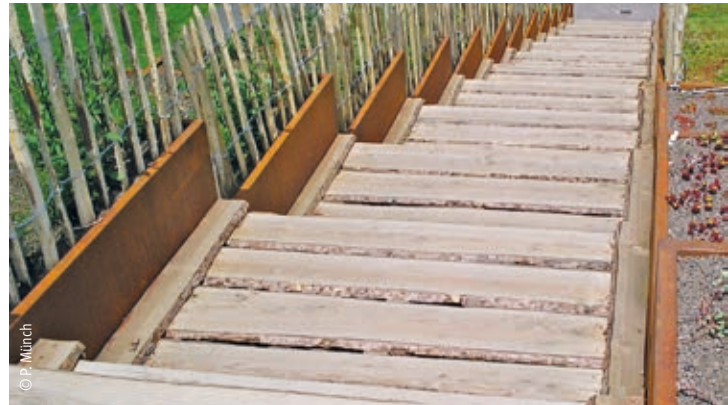
Holztreppe, der Witterung ausgesetzt: Gebrauchsklasse 3.2
