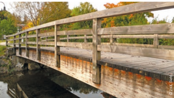
Holz im Außenbereich
