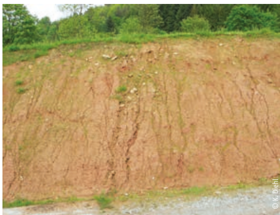
Erosionserscheinungen an einer Straßenböschung
